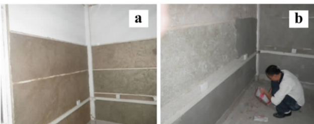
图3 石膏基保温砂浆的施工(a.保温层的施工;b.抹面层的施工)
